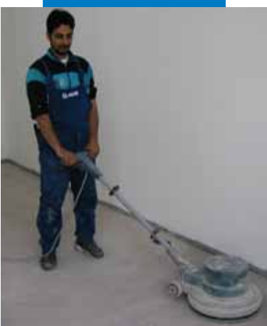
Carteggiatura prima della stesura di Ultraplano Eco - Asilo Mirabello di Cantù - Italia
